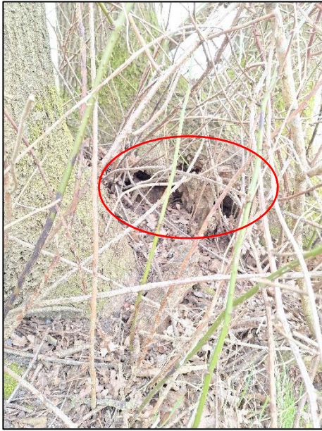
Abbildung 28: Stammfußhöhlen in einer Stieleiche entlang der Straße Höchster Berg , Baumnr. 72 (Planungsbüro ALSE 19.03.2024)
