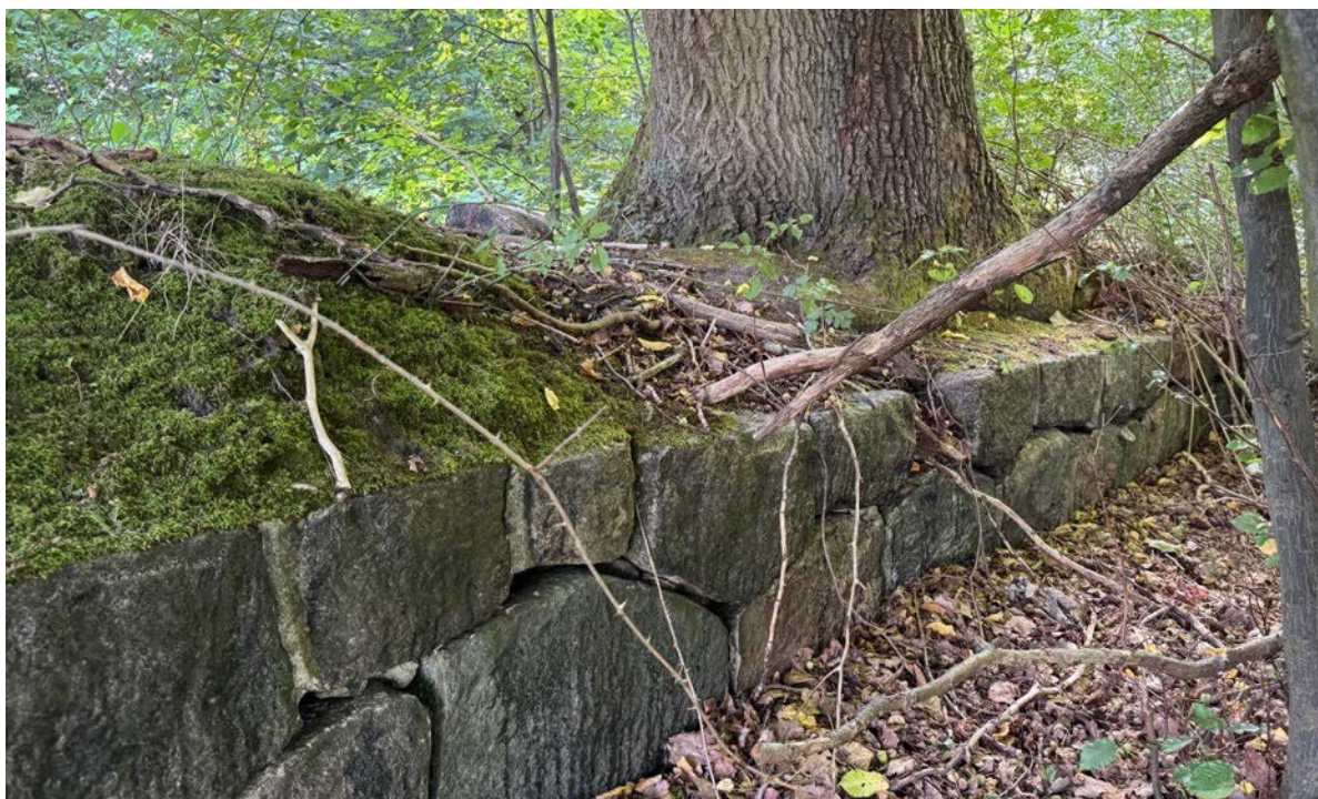
Abbildung 8: Baumbestand auf der ehemaligen Verladerampe im südöstlichen Plangebiet. Eine dauerhafte Verkehrssicherung ist nicht möglich. A+S, 2025
