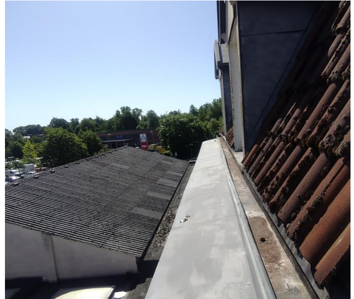
Foto 8: Dachbereiche mit der Möglichkeit für z.B. Nester von Haussperlingen unter Dachpfannen.
