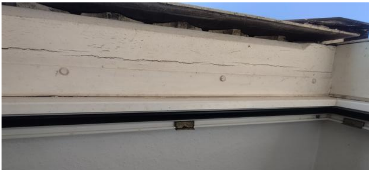
Foto 9: Fassadenüberstand an Fenstern mit Spalt, Tagesquartierpotenzial für Fledermäuse
