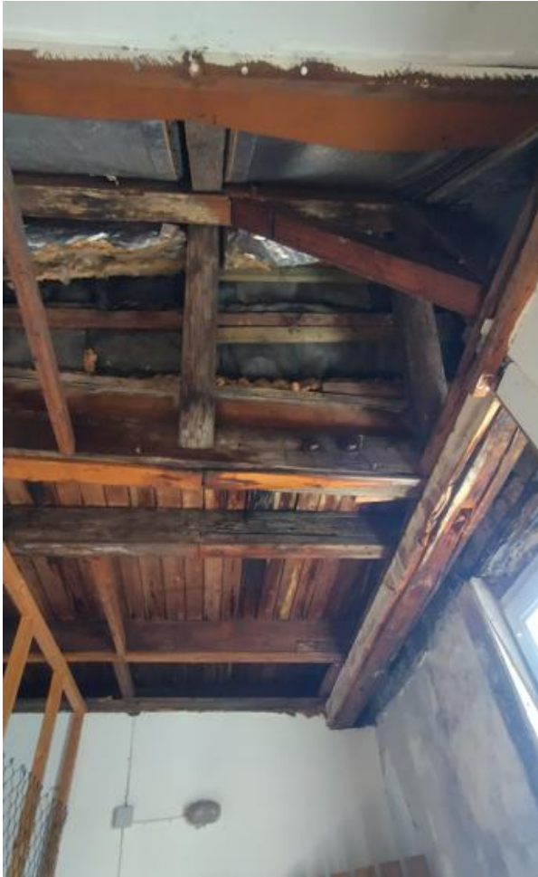
Foto 7: Dachstrukturen mit Holzbalken und Holzverschalung, Schäden durch Feuchtigkeit, keine Spuren von Fledermäusen, keine Zugänglichkeit von außen.
