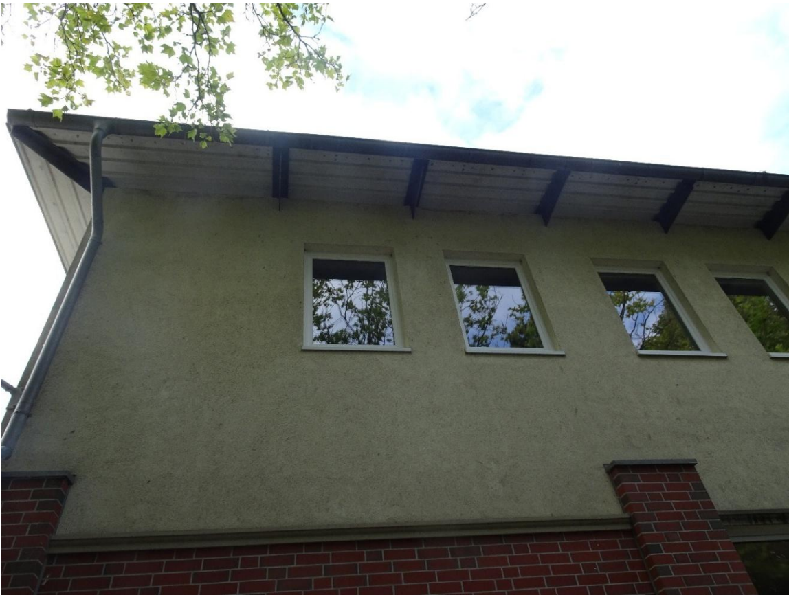
Abbildung 4: Königstraße 20, Blechdach mit geringem FM-Potenzial, Fenster ohne FM-Potenzial
